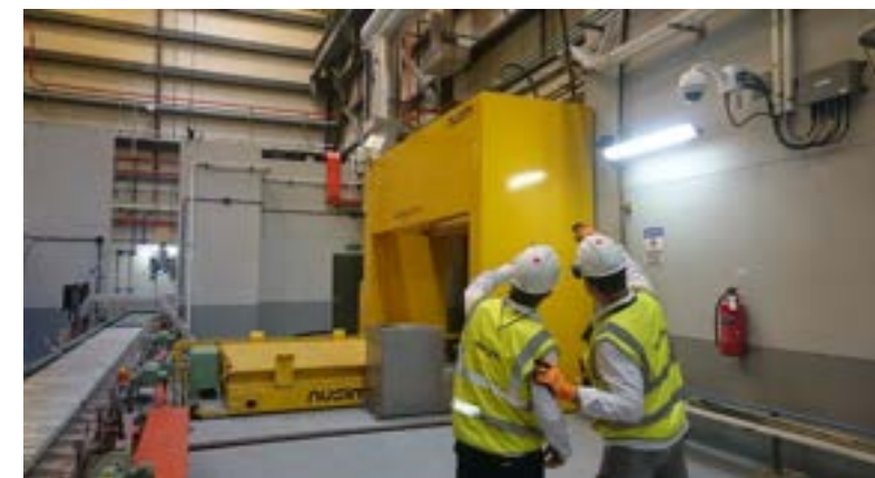
Planta de tratamiento de residuos NORM (UAE)
